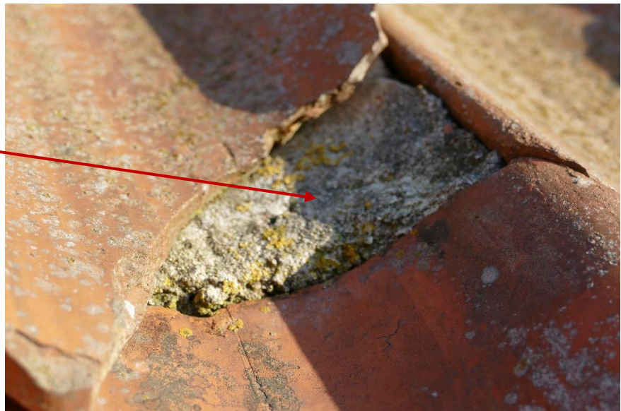
21. Ubytki i nieszczelności nakrywy muru.
